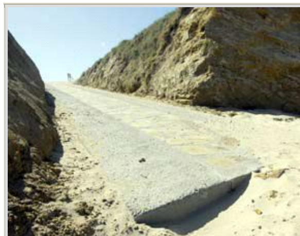
Los ecologistas denunciaron también la utilización de hormigón D.ALEXANDRE
