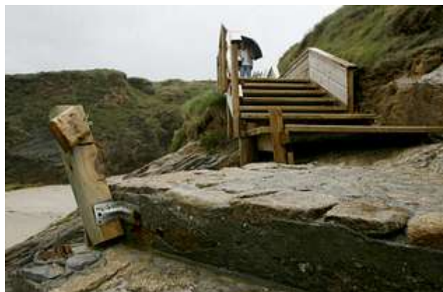
Escalera con deficiencias y varias roturas para entrar a una de las calas en Santa Comba FOTOS: JOSÉ PARDO
